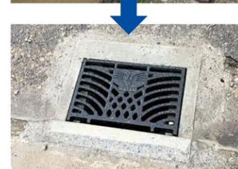
▲ウォッチングで発見した箇所を修繕依頼
